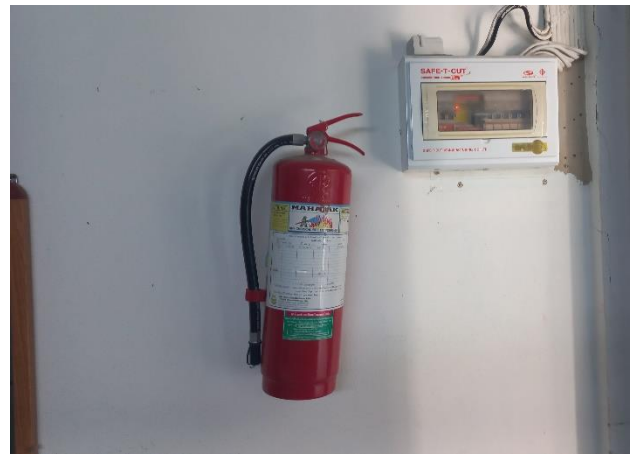
๔. มีการติดตั้งถังดับเพลิง
